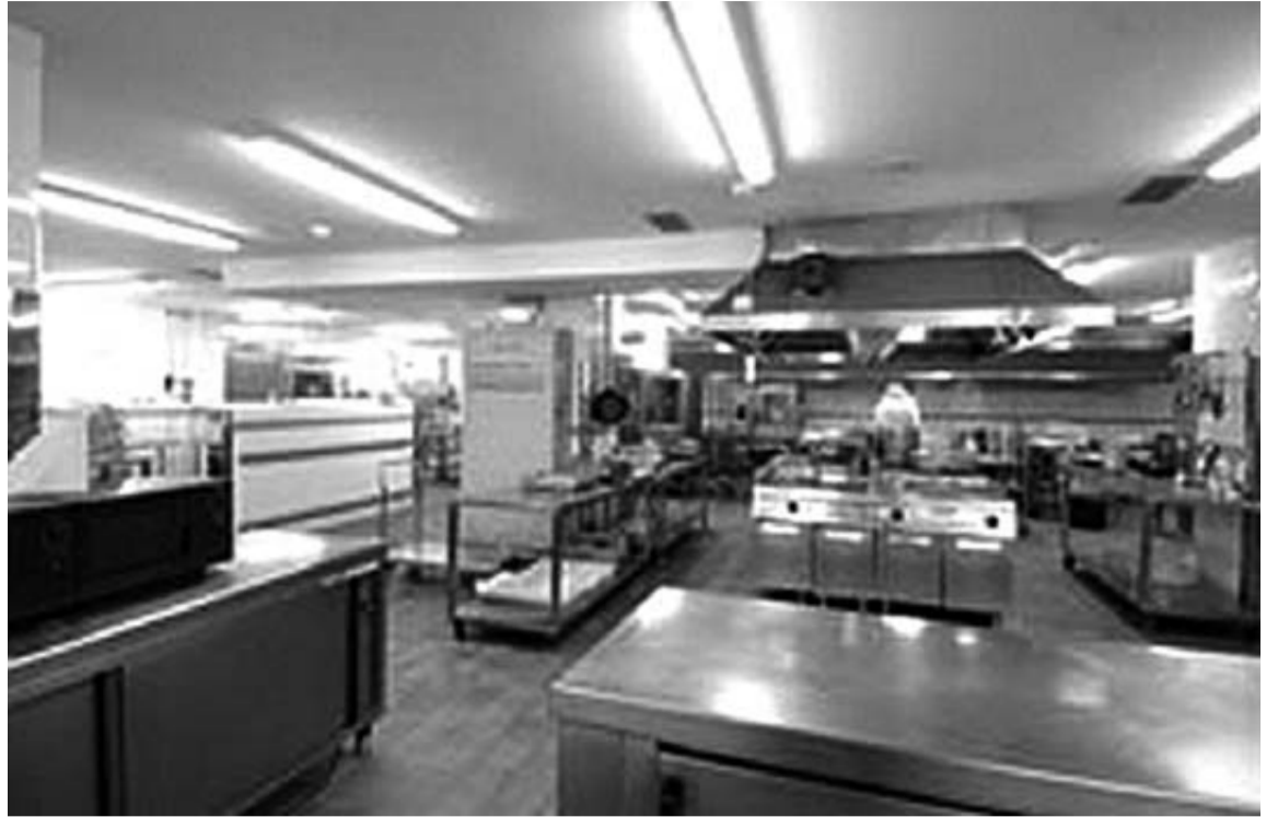
Nuevas cocinas del Complejo Hospitalario de Navarra.
